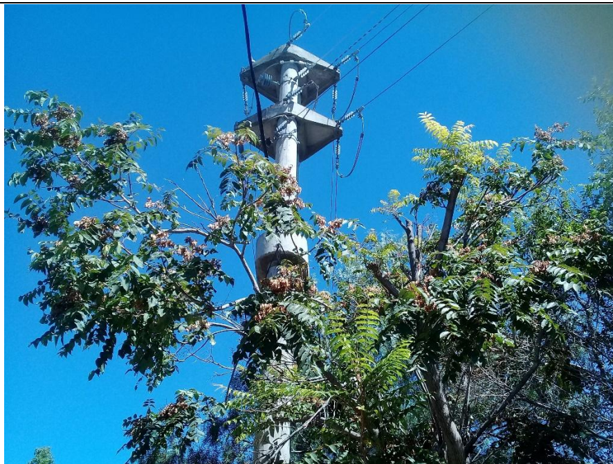
Foto 8: Ubicación desacertada de árboles próximos a estructuras de conducción eléctrica.
