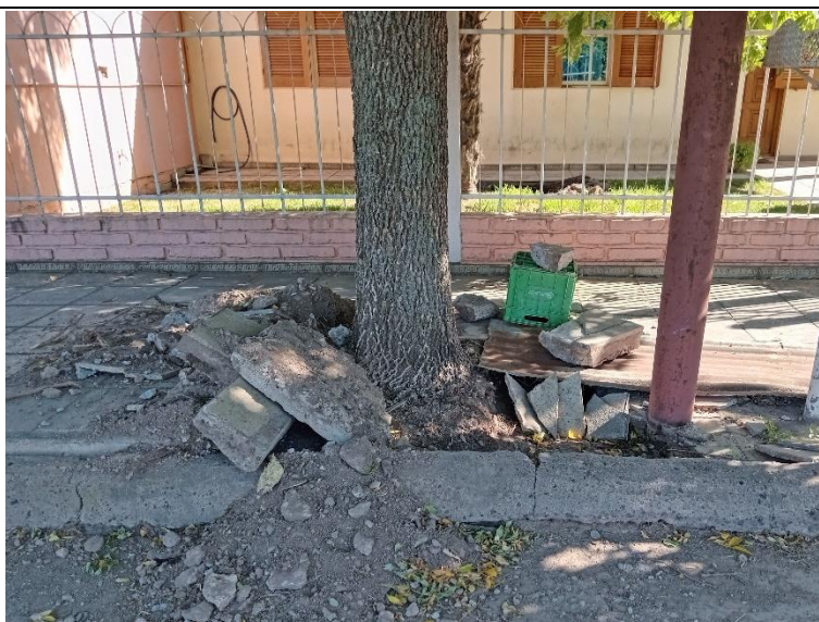
Foto 20: Interferencia de árbol de vereda con estructuras de conducción de agua.
