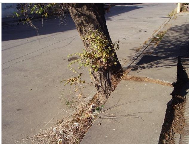
Foto 4: Vereda sin banda verde, cazuela de riego inexistente y levantamiento de mampostería.
