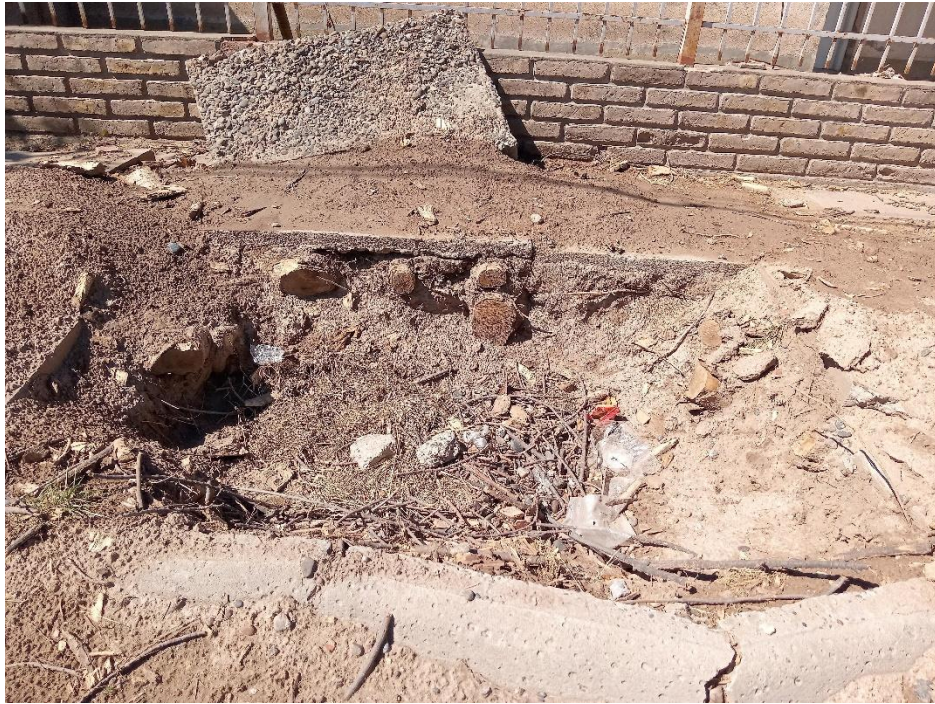
Foto 17: Cordón cuneta y vereda destruida por raíces de fresno americano.
